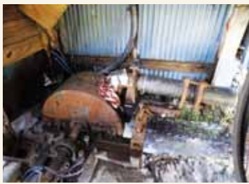
小水力の一例(約3kW)
