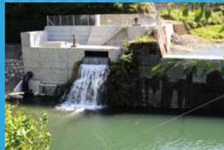
梶原町小水力施設
